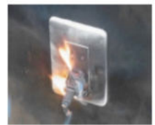
トラッキング火災に注意！
